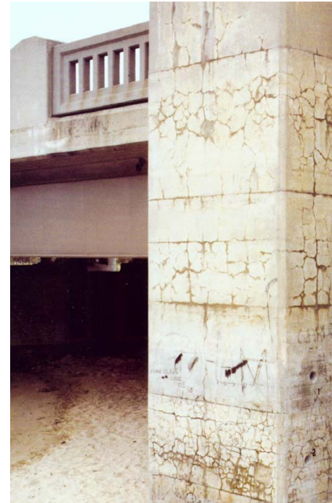
Poškozený mostní pilíř
