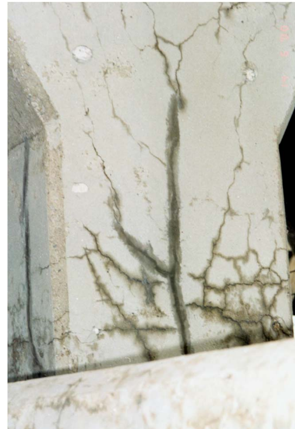
Detail– prokreslené trhliny
