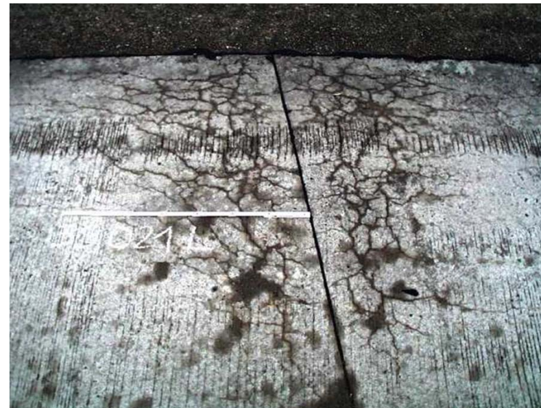
Trhlinová síť v málo pojížděném místě odbočovacího pruhu
