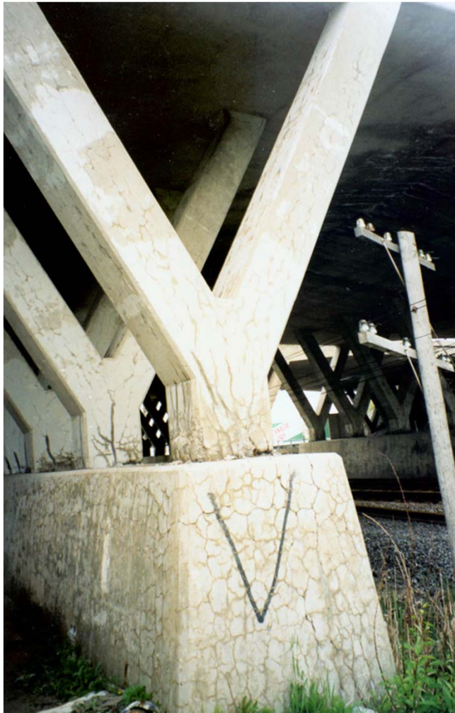
Dálniční most – poškozený základ pilíře
