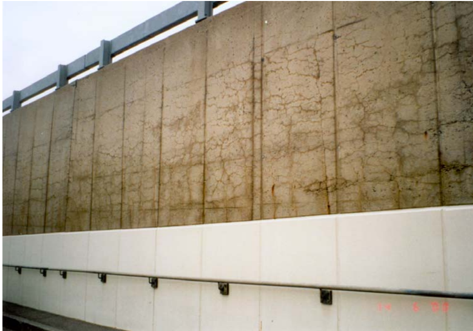
Poškození opěrné zdi
